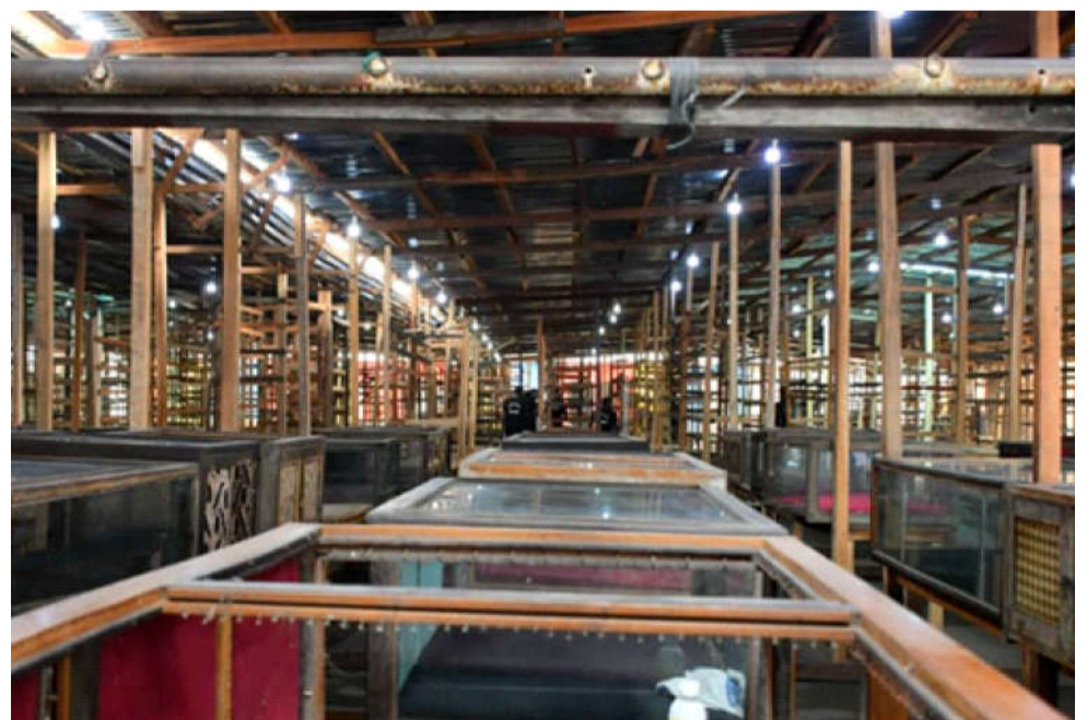
Un pavillon réhabilité du marché provisoire d'Itaga, commune de Kinshasa (Photo Service presse Hôtel de ville)
